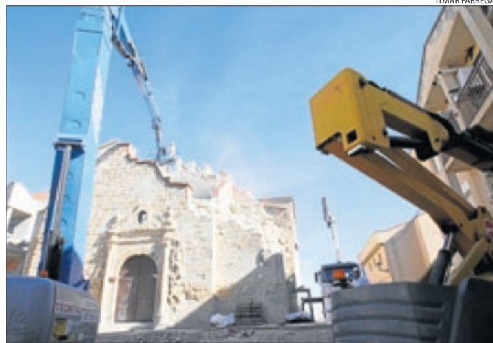
Imatge d'arxiu de l'església de Rosselló després de l'esfondrament.
