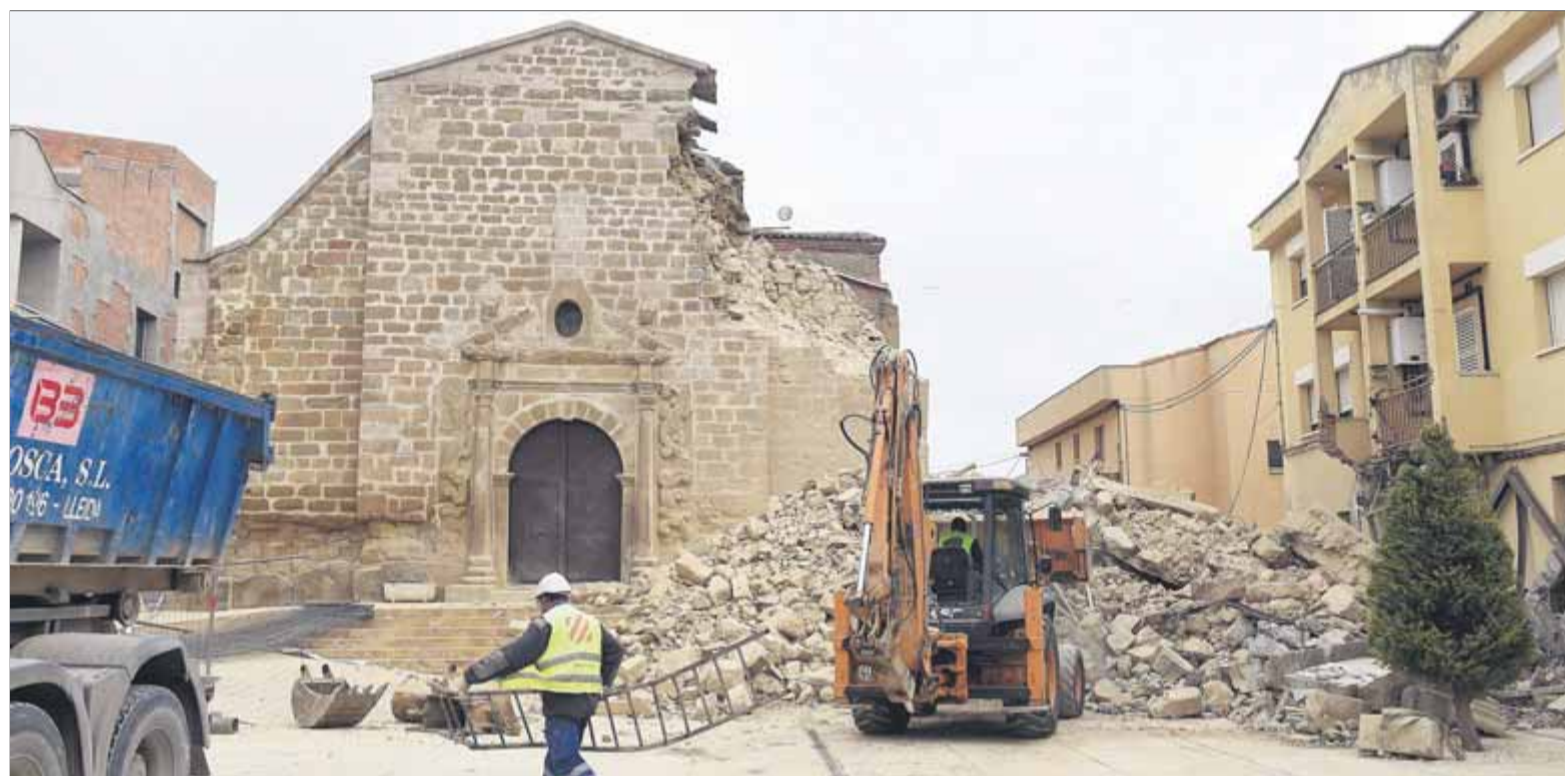
Treballs de desenrunament que es van fer els dies posteriors a l'esfondrament. Ara, les administracions ajudaran el Bisbat a reconstruir el temple ■ S. IGLESIAS
