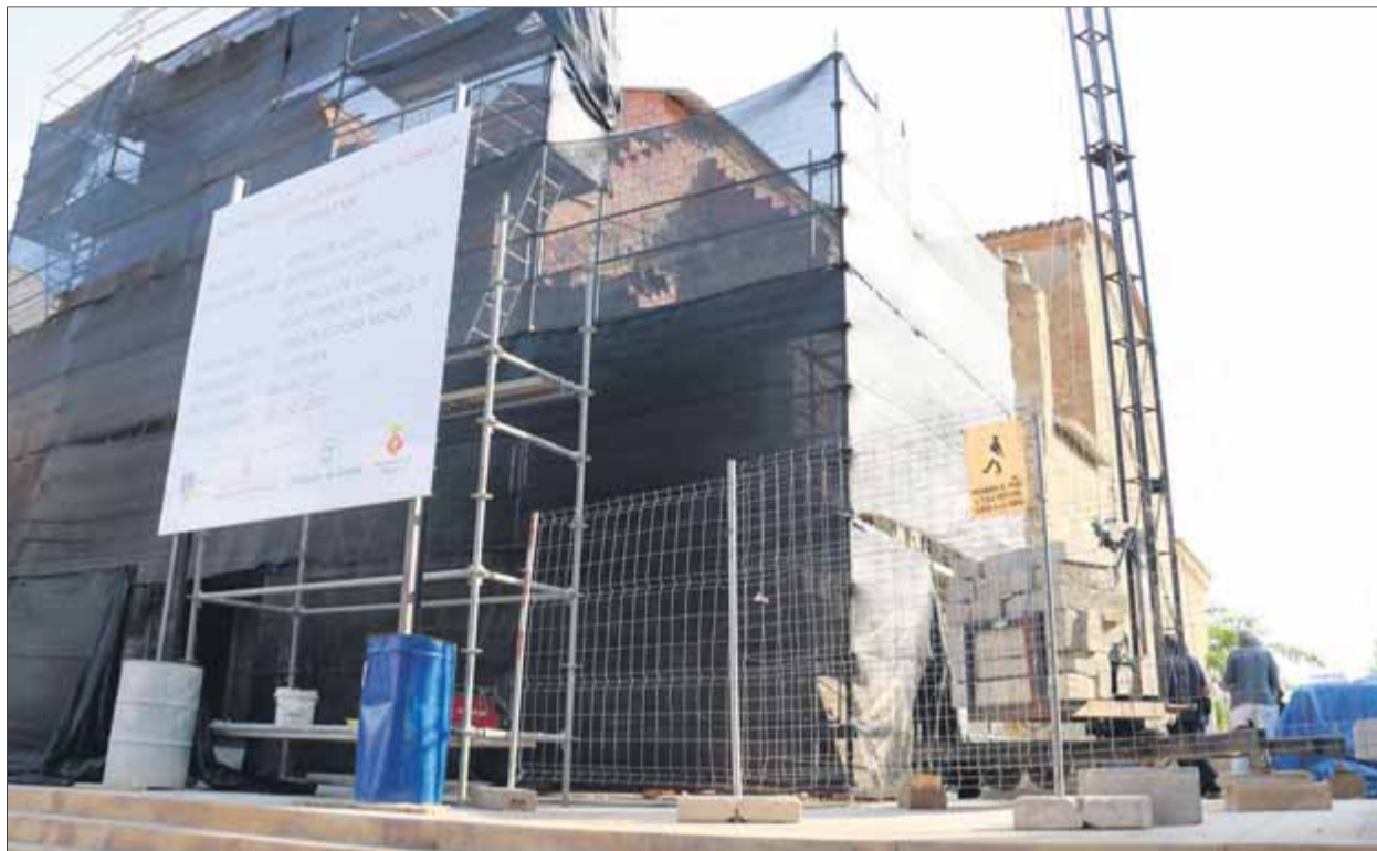
La façana i el forat del campanar coberts per una lona i una gran bastida en l'inici de les obres de recuperació ■ S. MIRET / ACN
