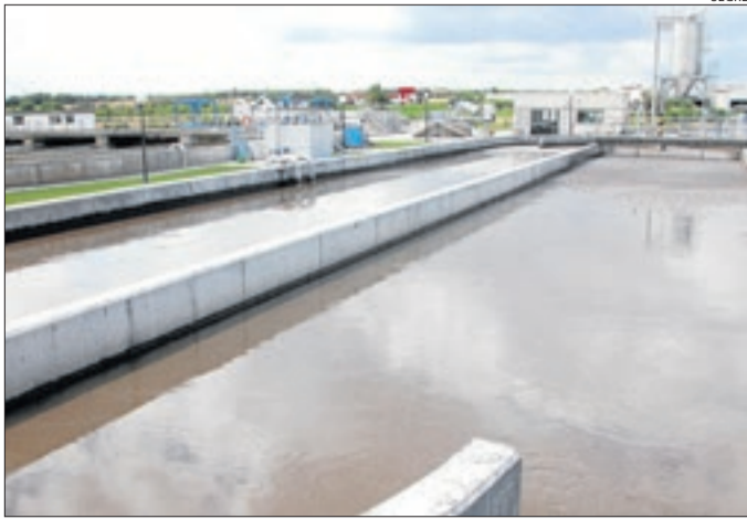
Imatge d'arxiu de la depuradora de Tàrrega.
