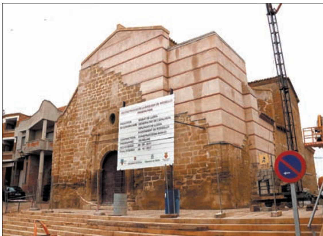
FOTO: ACN / La coberta ja s'ha arreglat però falta encara instal·lar el terra i pintar l'interior del temple
