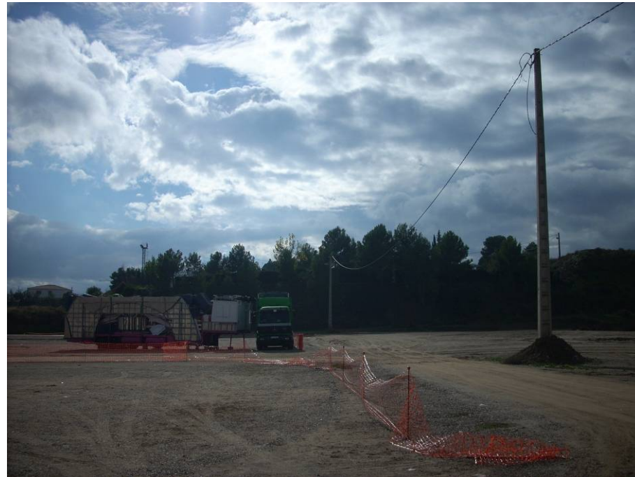
FOTO 36. Línia elèctrica que travessa el sector.
