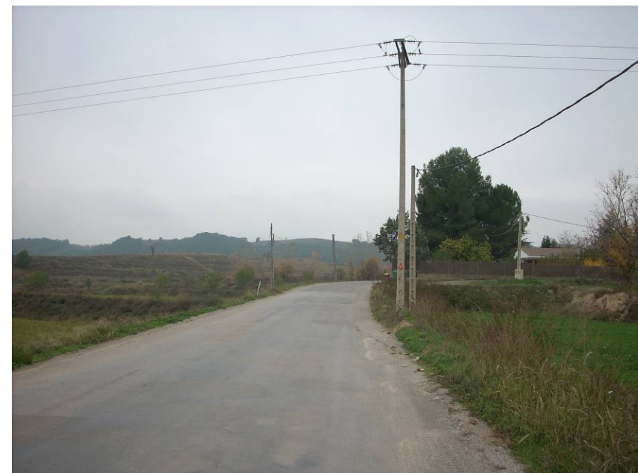
FOTO 59. Igual que foto anterior en sentit oest. Actual ubicació de les línies elèctriques aèries.
